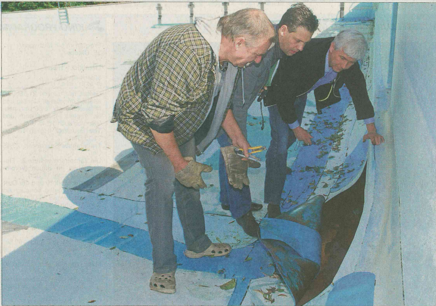
Zunächst öffnen (von links) Betriebsleiter Jörg Schmidtke, André Brand und Marek Gagarek die Folie, um die Beckensohle des Freibades begutachten zu können. Fotos: Schütze
